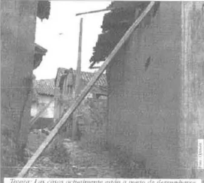
Totora: Las casas actualmente están a punto de derrumbarse
